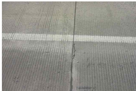
포장부 SPAN.80 파손
