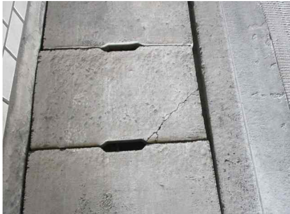
공동구 SPAN.6 덮개 파손
