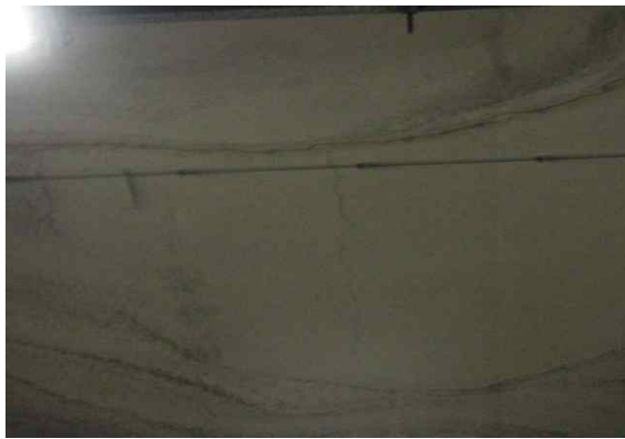
라이닝 SPAN.18 균열(0.3mm 미만)
