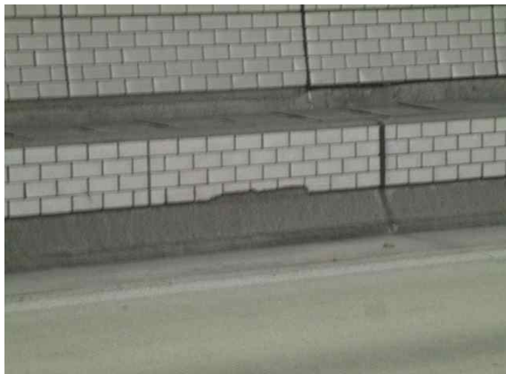
측벽부 SPAN.151 타일 파손
