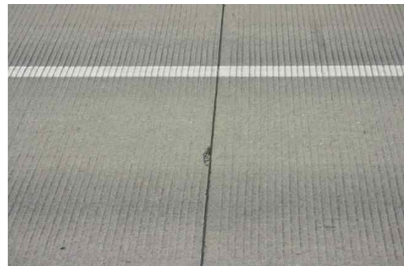
포장부 SPAN.102 파손
