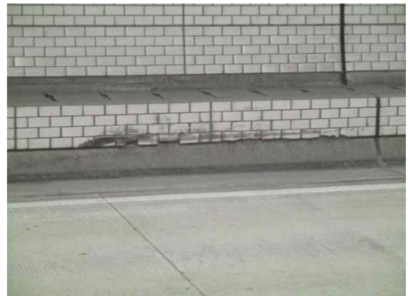
측벽부 SPAN.208 타일 파손
