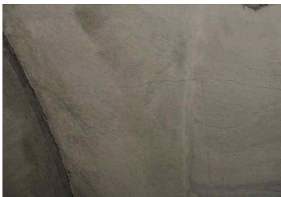
라이닝 SPAN.182 균열(0.3mm 이상)
