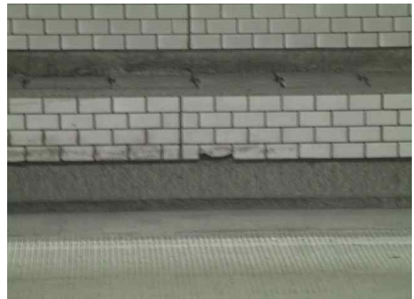
측벽부 SPAN.161 타일 파손
