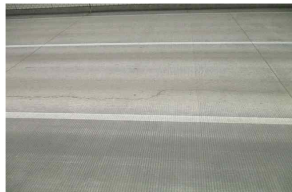
포장부 SPAN.210 균열(0.3mm 이상)
