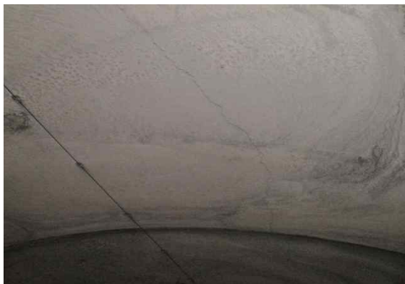
라이닝 SPAN.101 균열(0.3mm 이상)
