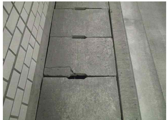
공동구 SPAN.191 덮개 파손
