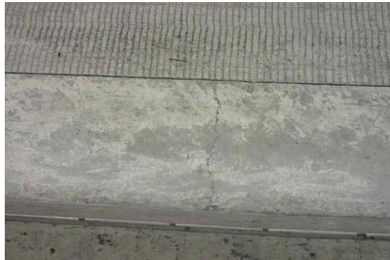
포장부 SPAN.22 균열(0.3mm 이상)
