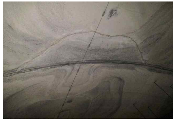
라이닝 SPAN.27 균열(0.3mm 이상)
