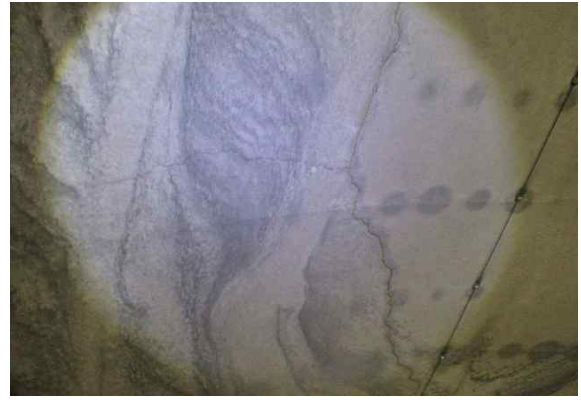
라이닝 SPAN.5 균열(0.3mm 이상)
