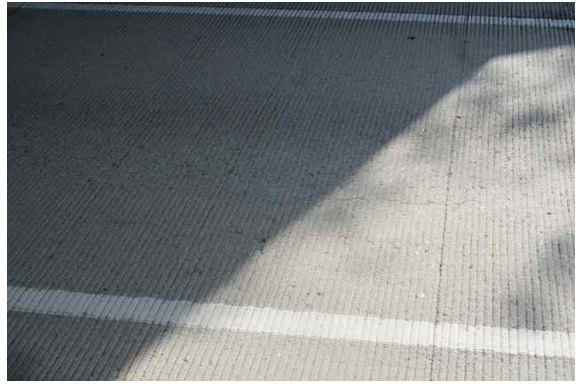
포장부 SPAN.1 균열(0.3mm 이상)
