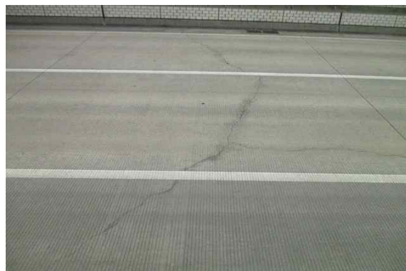
포장부 SPAN.186 균열(0.3mm 이상)
