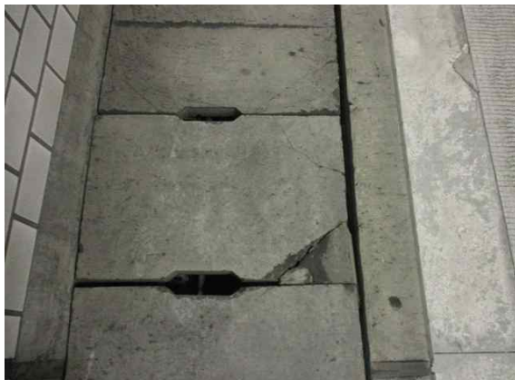
공동구 SPAN.43 덮개 파손
