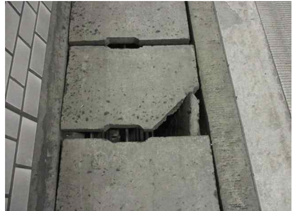
공동구 SPAN.11 덮개 파손
