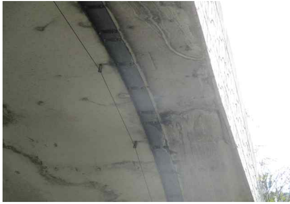
라이닝 SPAN.1 균열부 백태
