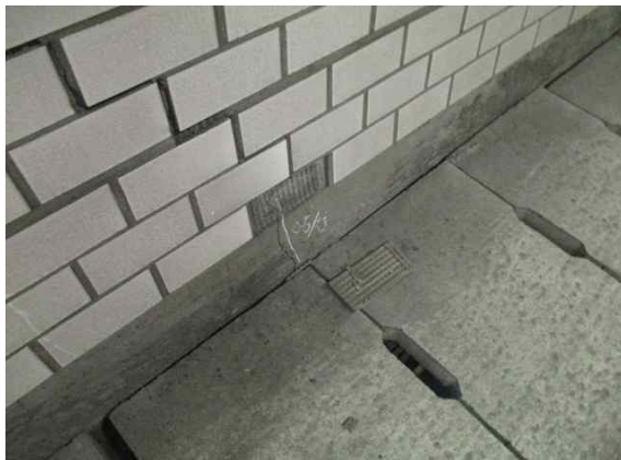
측벽부 SPAN.185 균열(0.3mm 이상)
