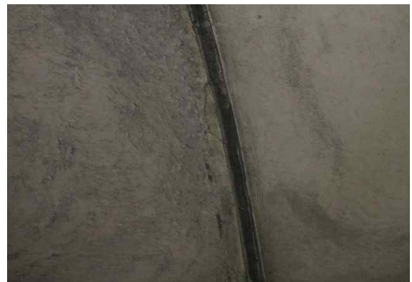
라이닝 SPAN.160 조인트부 들뜸
