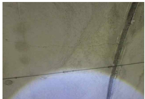
라이닝 SPAN.243 균열(0.3mm 이상)
