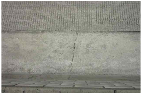
포장부 SPAN.52 균열(0.3mm 이상)
